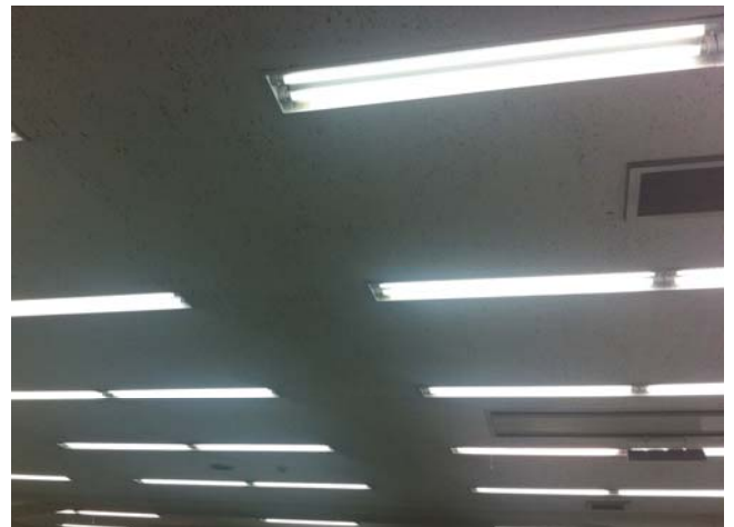
本社社屋に設置したLED照明
